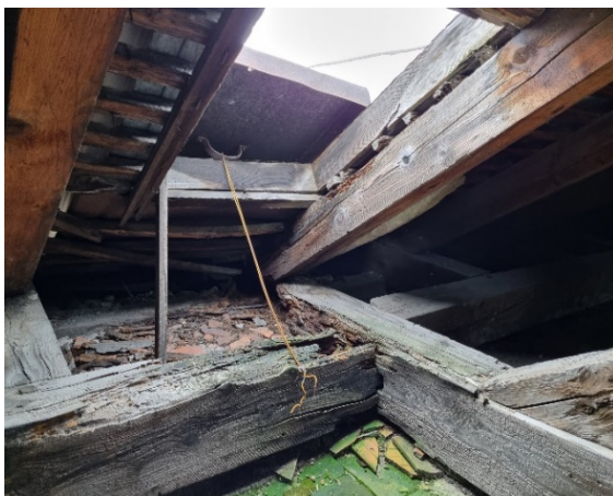
Obr. 4 – Väzný trám, výmena, pomúrnica, krokva: Stupeň poškodenia 4
