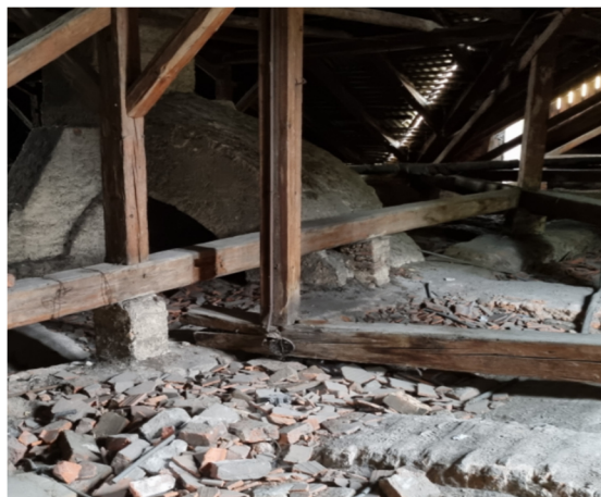
Obr. 6 – Zlyhanie prípoja väzných trámov: Úsek A-B-C
