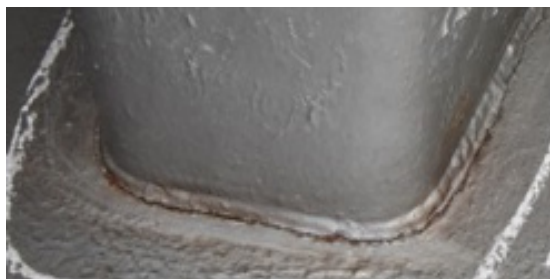
Obr. 8 – Trhlina zvarového spoja
