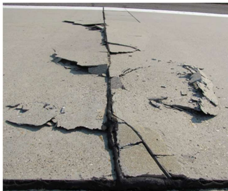
Obr. 1 – Porušenie vozovky vplyvom teploty
